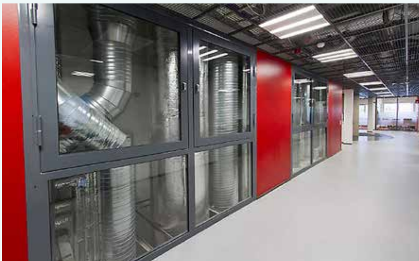
Kuvassa LVI-kuilu, jossa on yksi seinä läpinäkyvä, jotta opiskelijat voivat nähdä, mitä tekniikkaa kuuluu on sijoitettu. Myös alakaton tekniikka näkyy ritilöiden lävitse.
