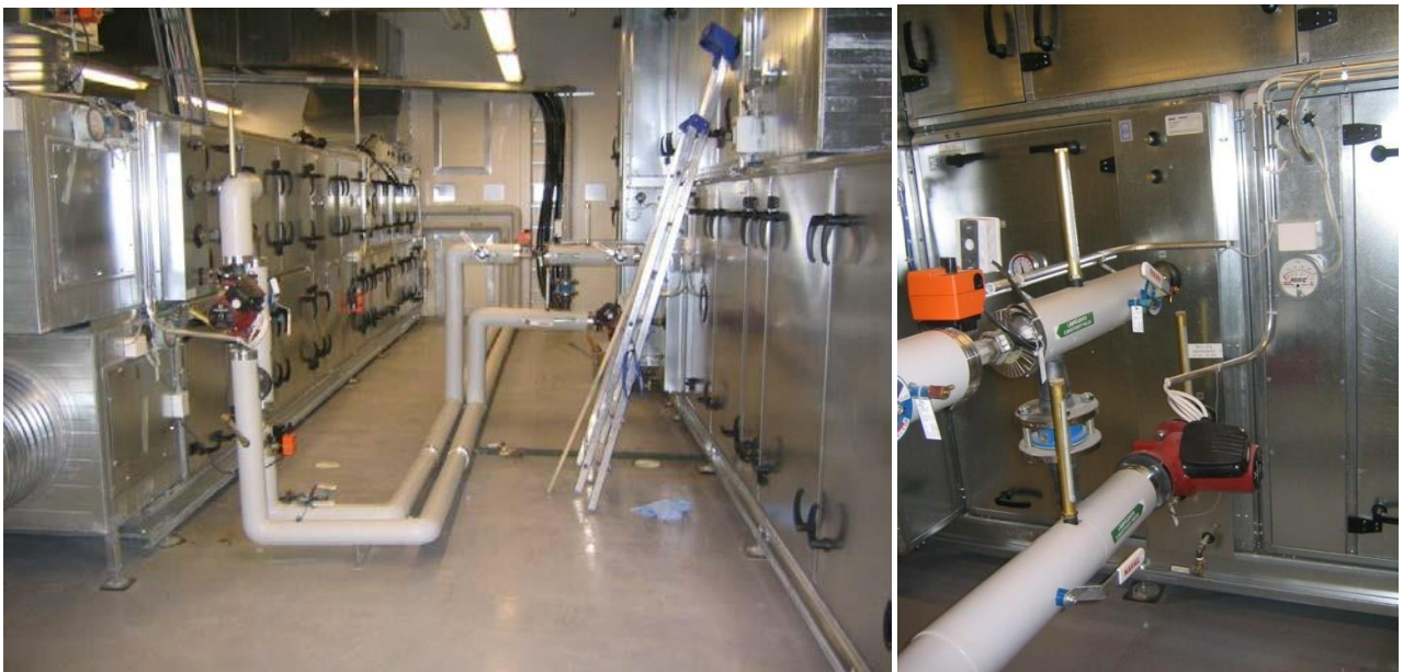
Kuva 4. Ilmanvaihtokoneen nestepiirien tarkistus; pumput, sulku- ja säätöventtiilit, lämpötila-anturit.
