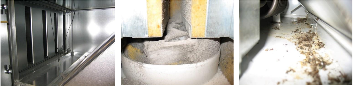
Kuva 3. Ilmanvaihtokoneen tarkistus sisältäpäin; äänenvaimentimien pinnoitteiden kunto ja puhtaus, yleinen puhtaus.
