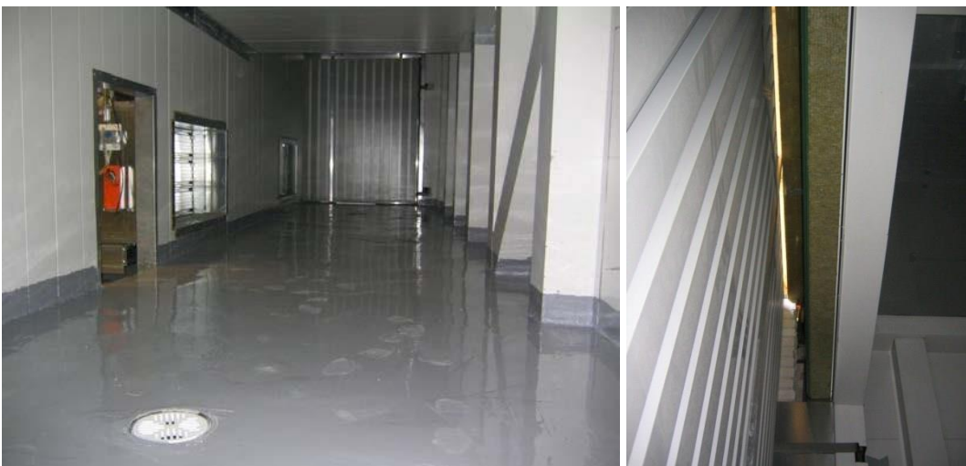
Kuva 5. Ilmanvaihtokoneen ulkoilmakammioiden kunto ja ilman sisäänoton tarkistus.
