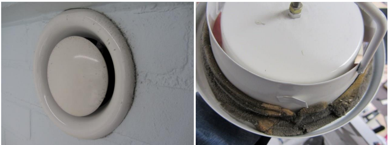
Kuva 2. Kohtuullisesti pinnalta huollettu poistoilman päätelaite voi vuotaa kanavaliitoksesta. Seurauksena on suhinaa ja likavanoja seinällä. Vaihtoehtoina ovat ikääntyneiden tiivisteiden vaihto tai kokonaan uudet päätelaitteet.
