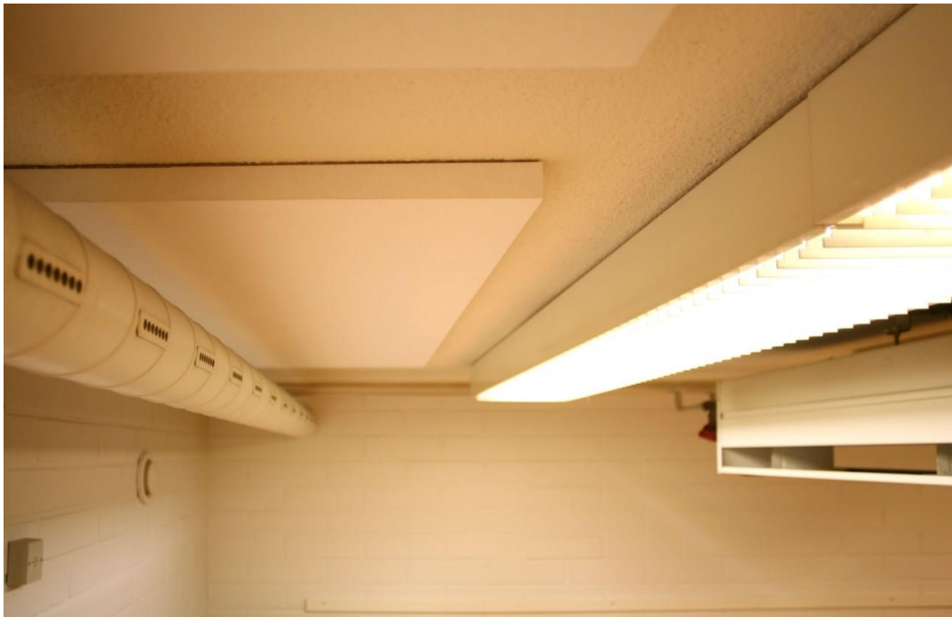
Kuva 6. Tuloilman päätelaitteen ilmavirran edessä ei saa olla virtausta häiritseviä esteitä. Suunnitellusta poikkeava virtaus on usein vetovalitusten aiheuttaja. Tässä tuloilmavirta törmää valaisimeen ja jäähdytyspalkkiin.
