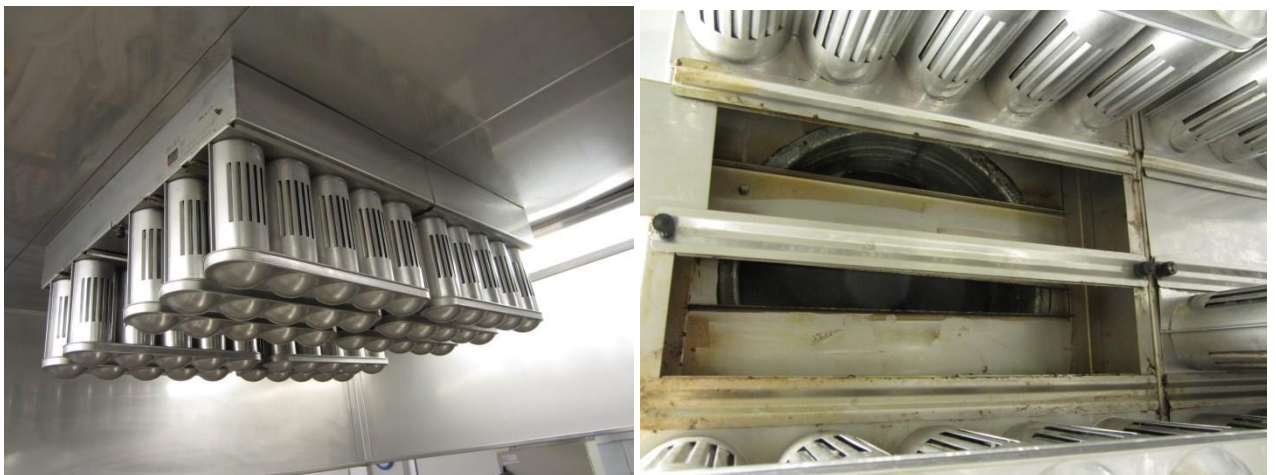
Kuva 4. Rasvanerottimilla varustettu keittiön poisto. Päivittäisellä pesulla rasvanerottimet säilyttävät toimintakykynsä ja ilmavirrat pysyvät suunnitelmien mukaisina. Kuntotarkastuksessa on kuitenkin syytä katsoa myös erotinyksiköiden taakse ilmakeanaviin ja tarkastaa säätöpeltien toimintakunto.
