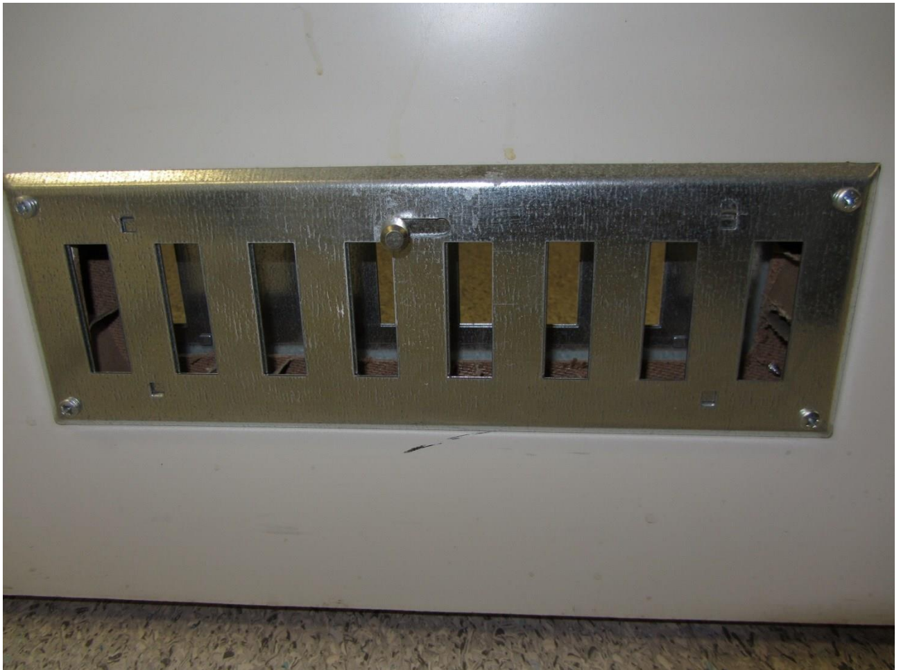
Kuva 3. Siirtoilmasäleikön sisäpuolinen kunto on tarkastettava. Esimerkiksi äänenabsorptiomateriaalin pinnoite on voinut ikääntyä ja irrota.
